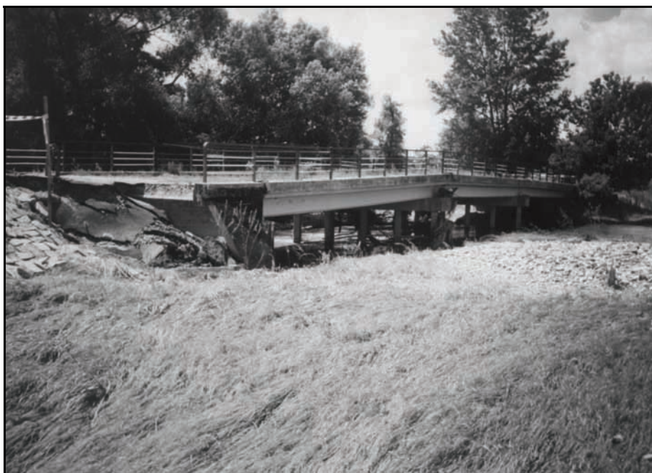
Fot. 1. Straty powodziowe w roku 1997, Odra, Krzyżanowice (źródło: arch. RZGW, Gliwice).
